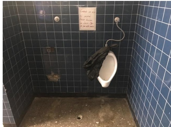
Orinales de baños en mal estado
