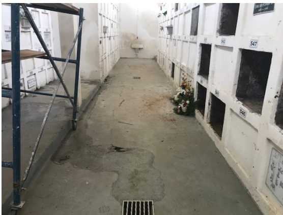
Nichos de alquiler en mal estado
