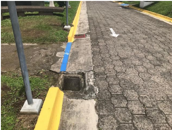
Cordones de caños sin rejillas
