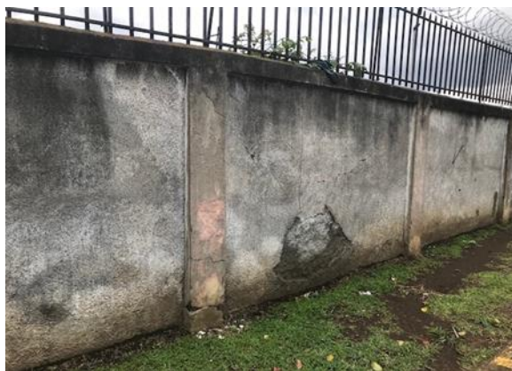
Paredes en mal estado
