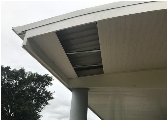
Deterioro de las capillas
