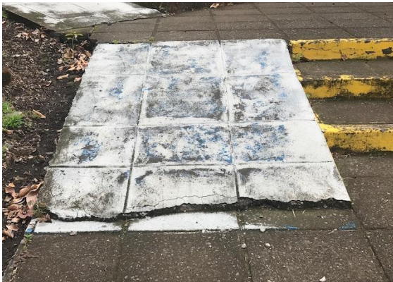
Deterioro y señalización borrosa
