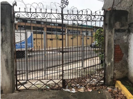
Portones en mal estado
