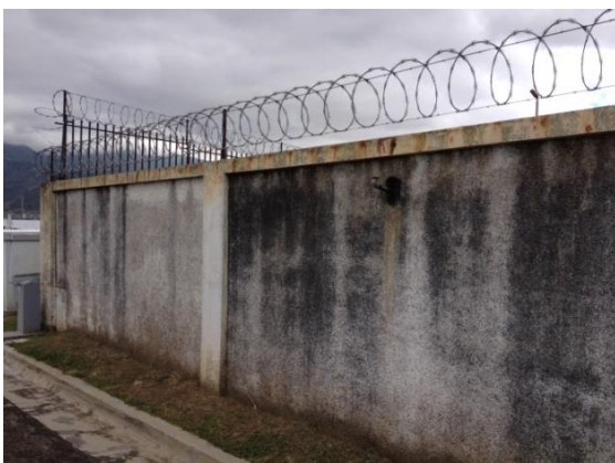
Paredes en mal estado
