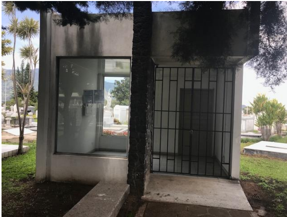
Refugios cerrados por mal estado
