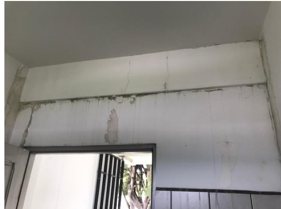
Refugios cerrados por mal estado
