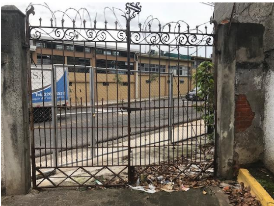
Portones en mal estado
